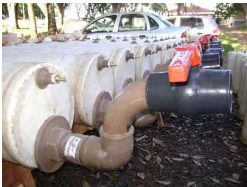
Figura 4. Saída dos biodigestores contínuos.
