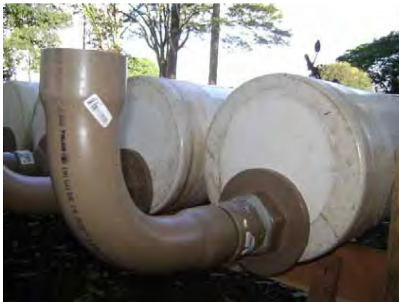
Figura 3. Entrada dos biodigestores contínuos.
