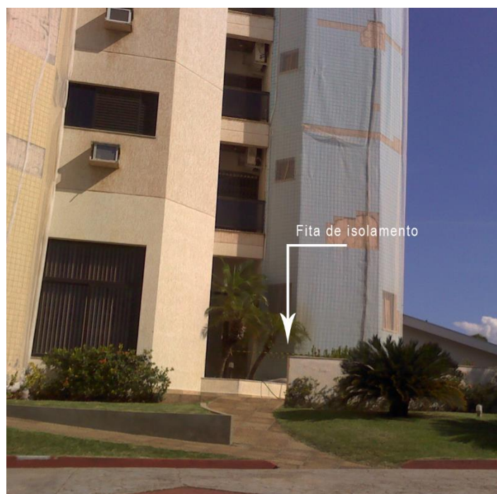
Figura 21. Detalhe de medida de isolamento da área de risco de queda.
