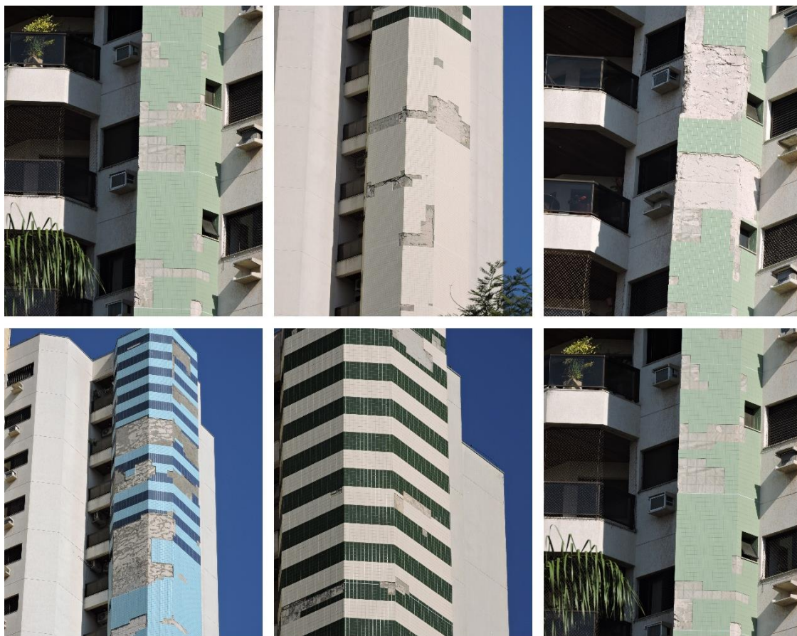
Figura 18. Alguns dos exemplos de deslocamentos presentes nas fachadas dos três edifícios do Condomínio Mares do Sul.
