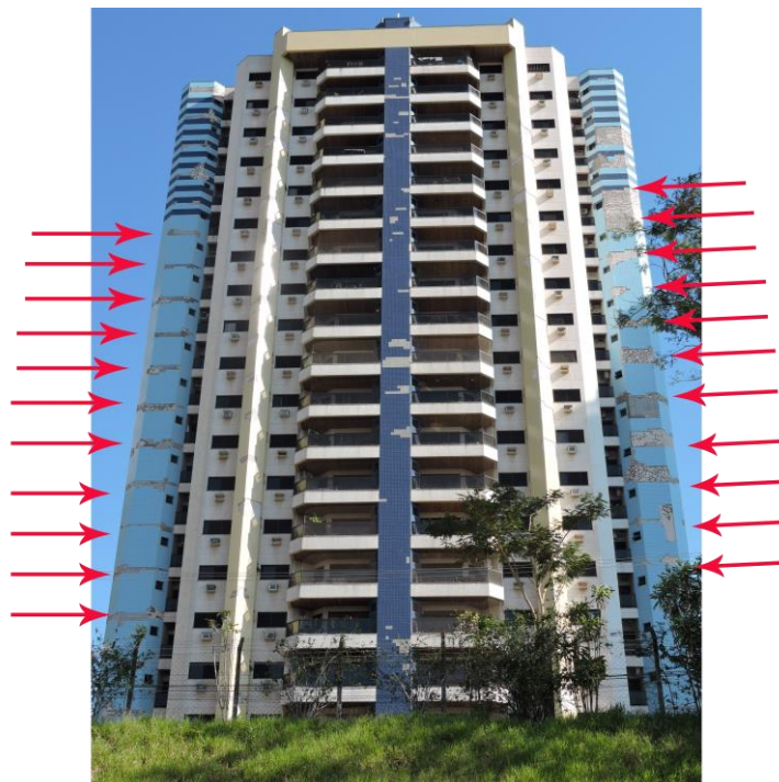
Figura 32. Sinalização do padrão de incidência das patologias no edifício 03, mostrando a relação com a estrutura.
