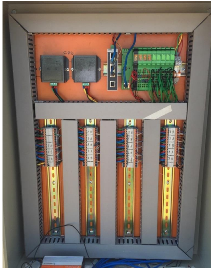
Figura 19 - Painel Elétrico Montado
