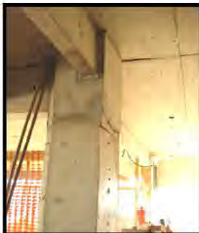
Figura 33 – Deformação geométrica (Fonte: Especificações Técnicas Gafisa – Estrutura concreto armado, pág. 11)
