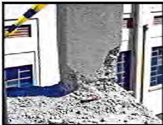
Figura 25 – “Bicheira” em pilar (Fonte: Consultoria e Análise. Disponível em: http://www.consultoriaeanalise.com/2009/06/falha-na-execucao-do-pilar.html )
