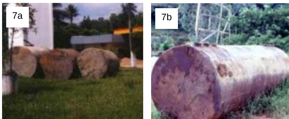
Figuras 7a e 7b – Tanques de combustíveis com problemas de corrosão
