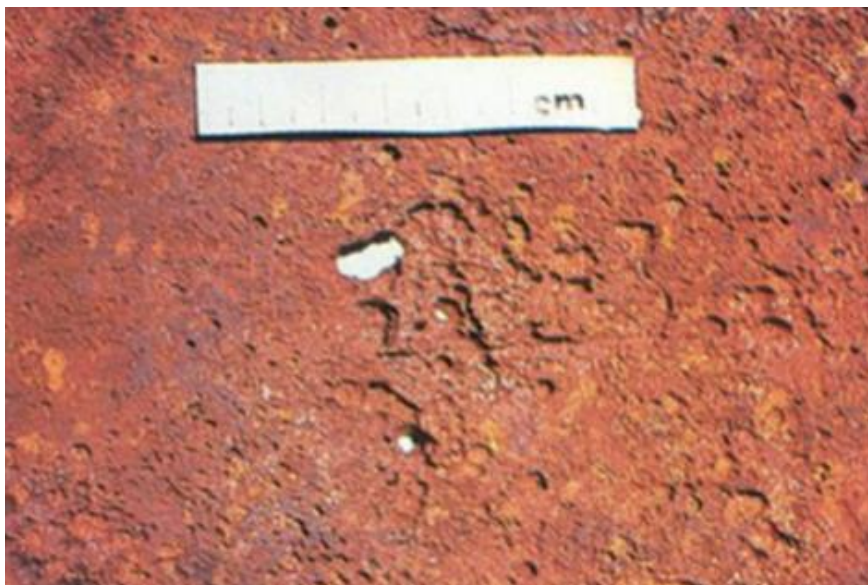
Figura 8 – Corrosão com perfurações na parte interna de tanque de óleo diesel
