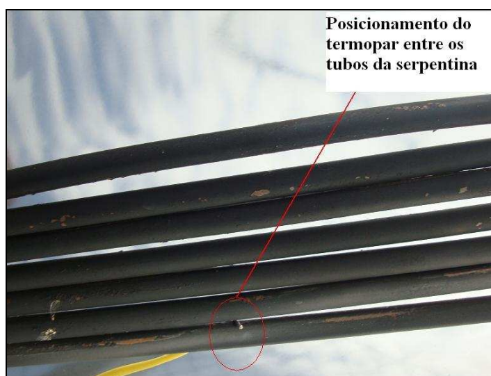
Figura 18 – Posicionamento do termopar na parede externa da serpentina
