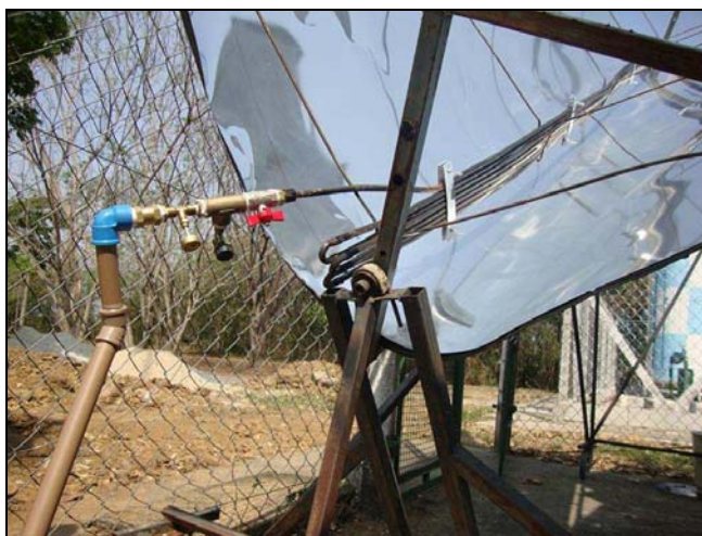
Figura 16 – Sistema de controle da vazão
