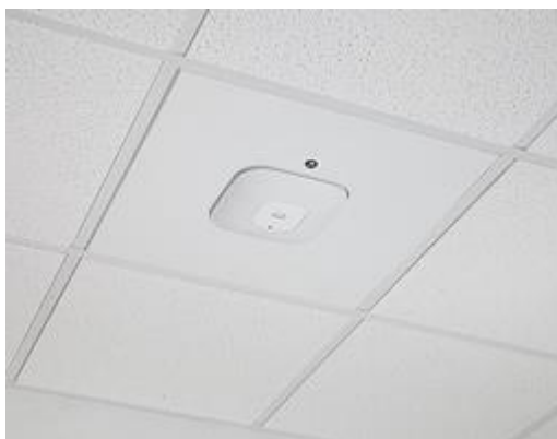
Figura 50 - Access Point instalado no teto
