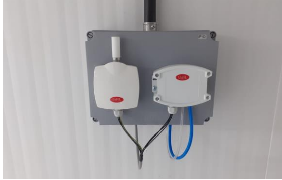
Figura 19 - Instalação sensor de umidade, temperatura e pressão para ar
