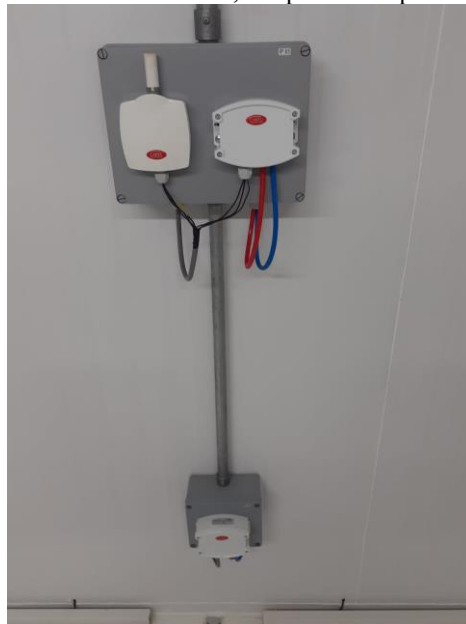
Figura 28 - Arranjo de sensores de umidade, temperatura e pressão instalados no duto PL
