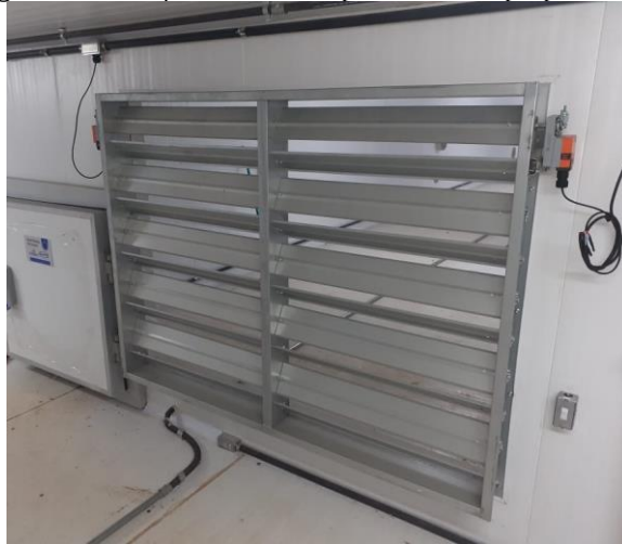
Figura 24 - Damper controlado por atuadores proporcionais
