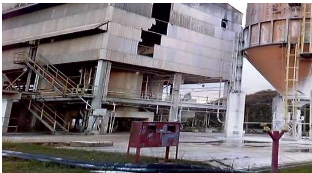
Figura 10. Vista da Estação de Neutralização de Águas Ácidas.
