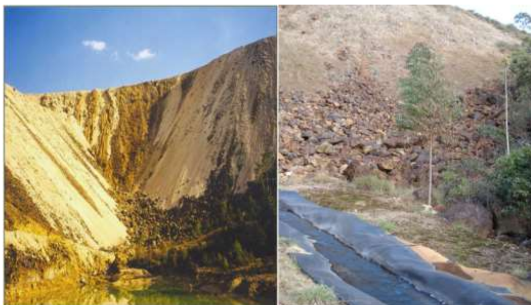
Figura 9. Bacia para captação de águas de drenagem ácida do BF-4, BNF (ponto 075)
