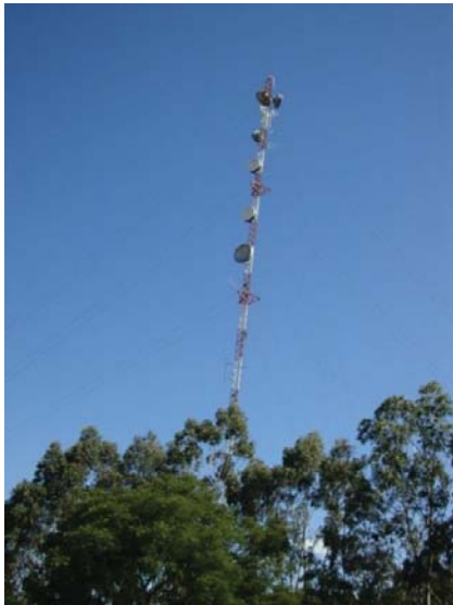
Figura 102 – Estação Rádio Base 31
