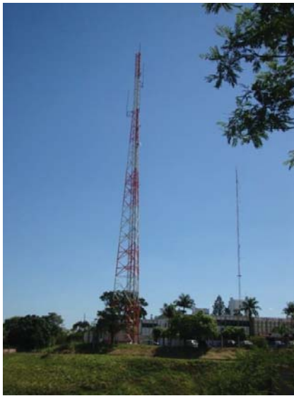
Figura 92 – Estação Rádio Base 27
