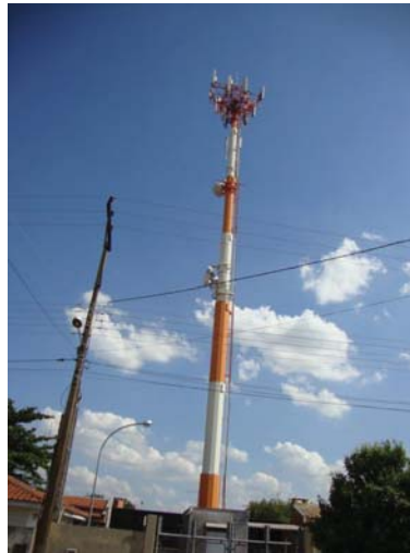
Figura 5 – Estação Rádio Base 15
