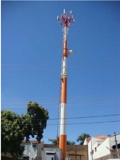
Figura 86 – Estação Rádio Base 25
