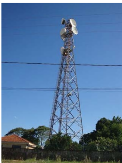
Figura 113 – Estação Rádio Base 35
