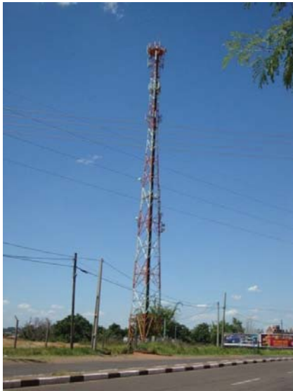
Figura 77 – Estação Rádio Base 22
