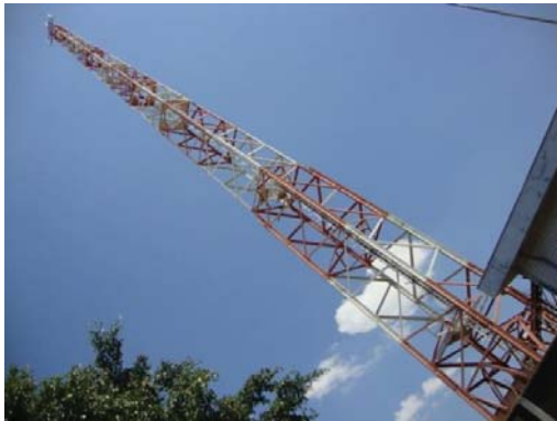
Figura 19 – Estação Rádio Base 3
