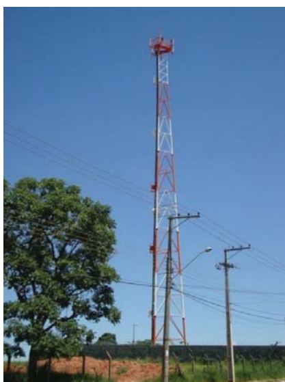
Figura 70 – Estação Rádio Base 19
