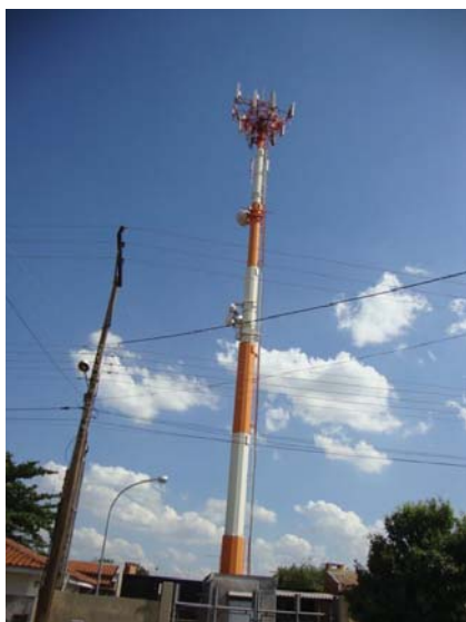
Figura 59 – Estação Rádio Base 15
