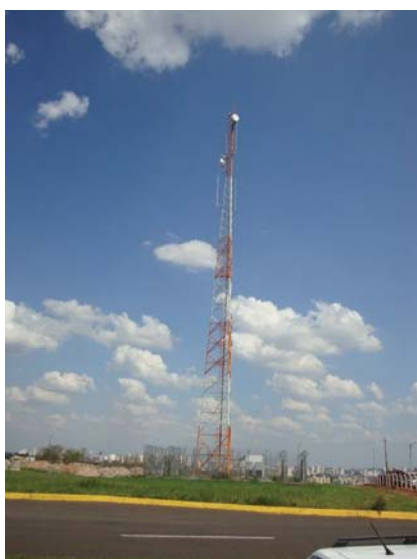
Figura 44 – Estação Rádio Base 10
