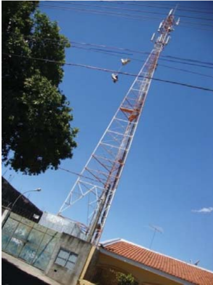
Figura 83 – Estação Rádio Base 24
