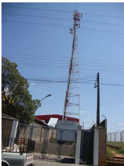
Figura 22 – Estação Rádio Base 4
