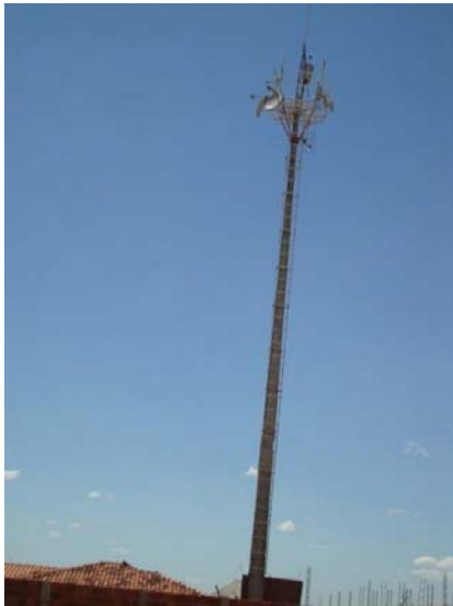
Figura 80 – Estação Rádio Base 23
