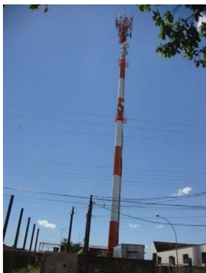
Figura 72 – Estação Rádio Base 20
