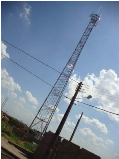
Figura 50 – Estação Rádio Base 12
