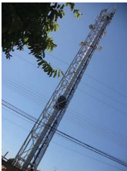
Figura 95 – Estação Rádio Base 28
