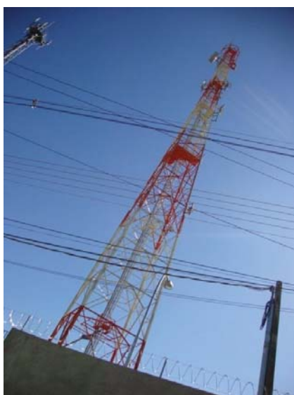
Figura 109 – Estação Rádio Base 33
