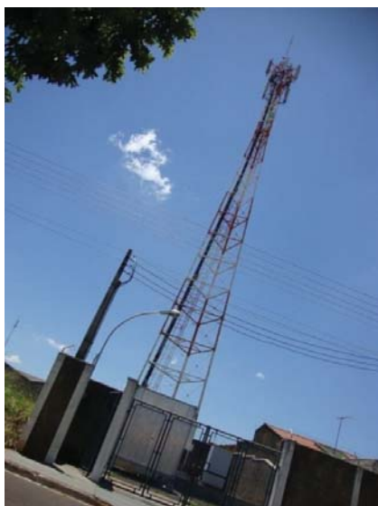
Figura 64 – Estação Rádio Base 17
