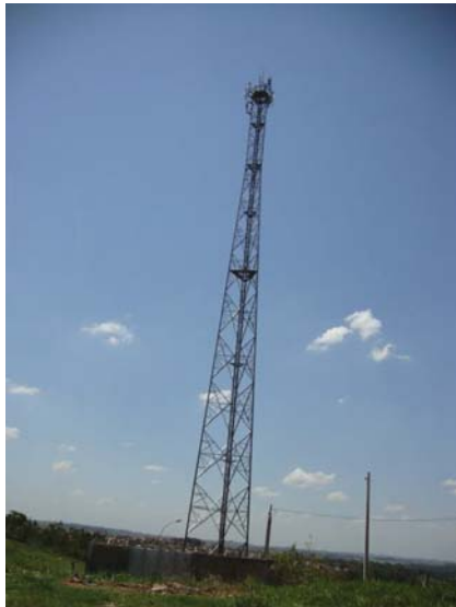
Figura 27 – Estação Rádio Base 5
