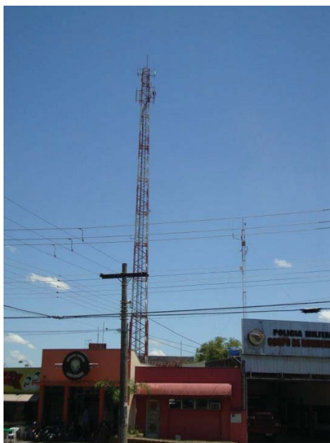
Figura 62 – Estação Rádio Base 16
