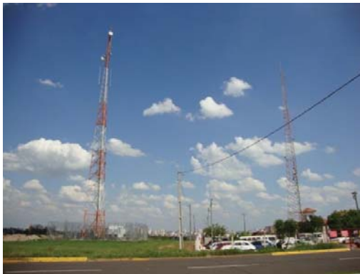
Figura 47 – Estação Rádio Base 11
