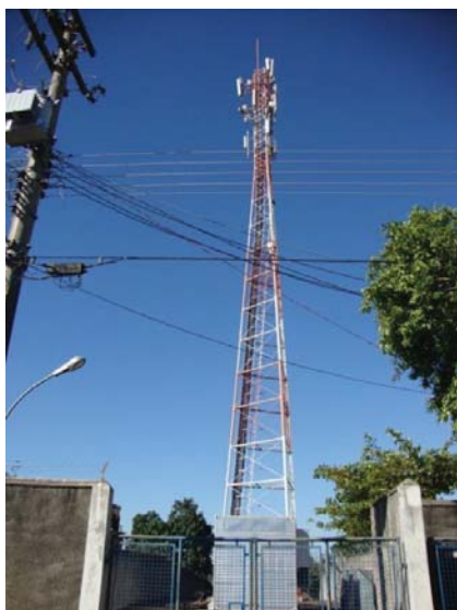
Figura 117 – Estação Rádio Base 36
