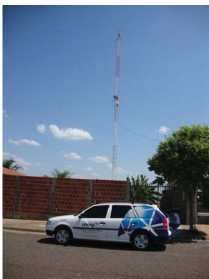
Figura 30 – Estação Rádio Base 6
