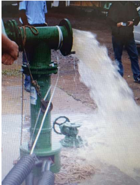
Figura 3 – Poço em Operação.
