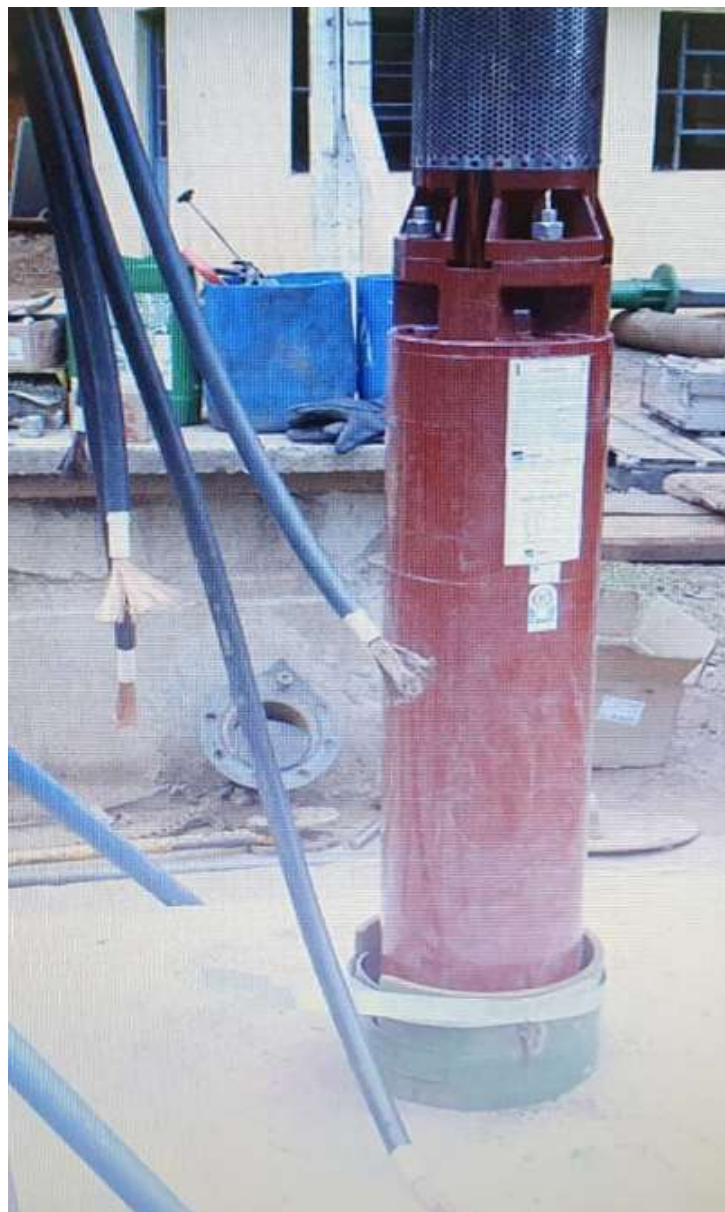
Figura 4 - Conjunto Motobomba Submersa Elétrica em poço
