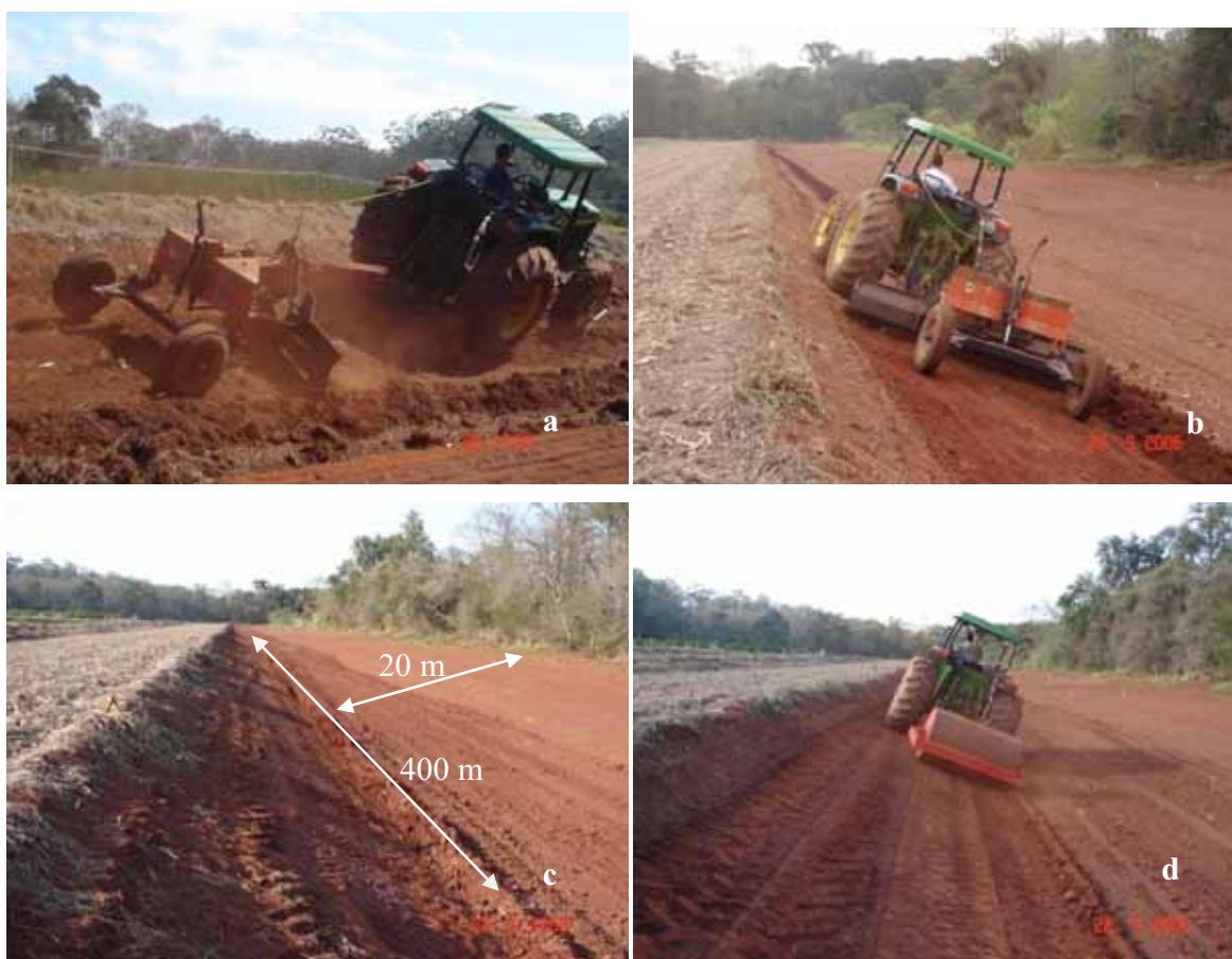
Figura 11 – (a) Preparo inicial da pista lateral com plaina (b) Preparo final da pista lateral com plaina (c) Pista lateral plainada (d) Rolo compactador.
