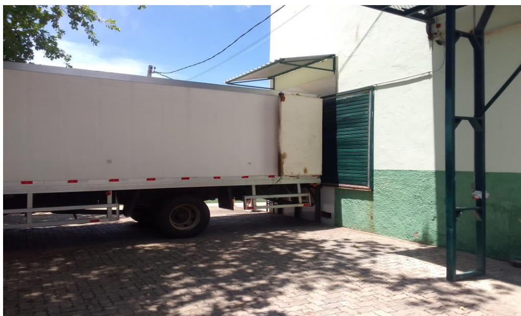
Figura 8 – Local das Câmaras frias/expedição de carnes
