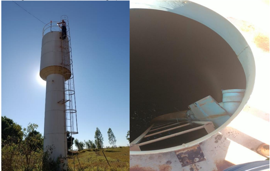
Figura 9 – Reservatório do poço assentamento Roseli Nunes
