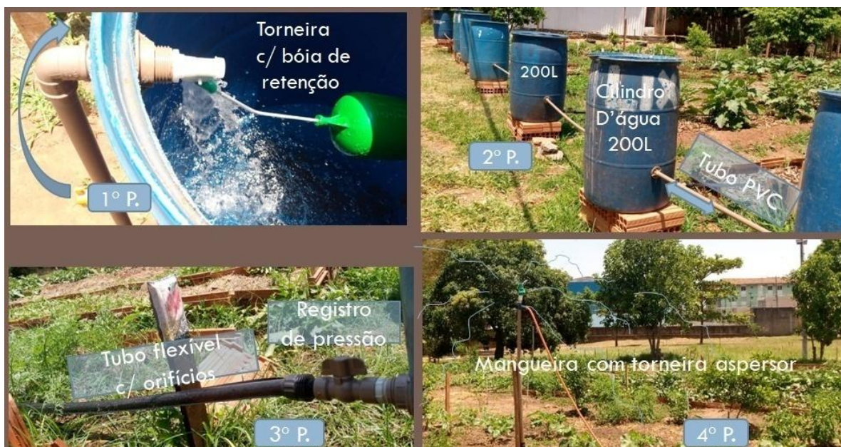
Figura 18: Sistema de irrigação instalado nas hortas da Vila Vicentina de Bauru.
