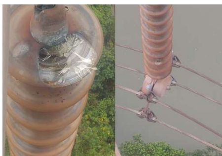
Figura 29 - Registros de descargas disruptivas na cadeia de isoladores
