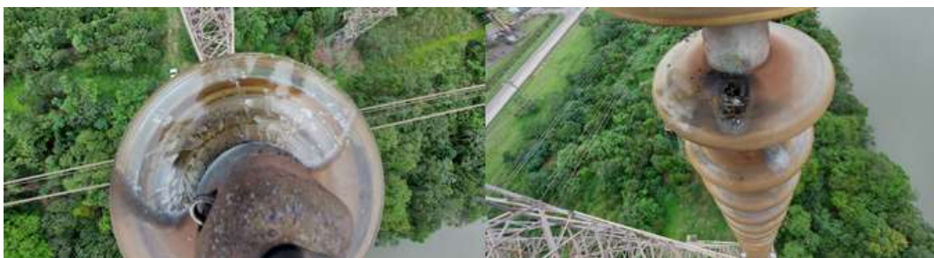
Figura 28 - Registros de descargas disruptivas na cadeia de isoladores
