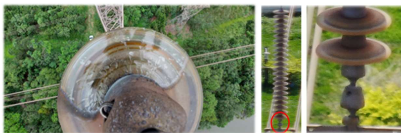
Fig. 5. Registros de descargas disruptivas na cadeia de isoladores e falta de discos isolantes
