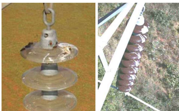
Figura 16 - Exemplo de contaminação de isoladores por excremento de pássaros
