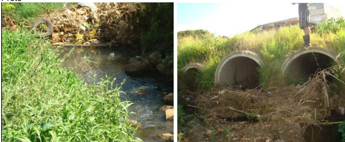
Figura 57. Seção transversal aberta e obstruída com resíduos tecnogênicos no arroio Barro Preto
