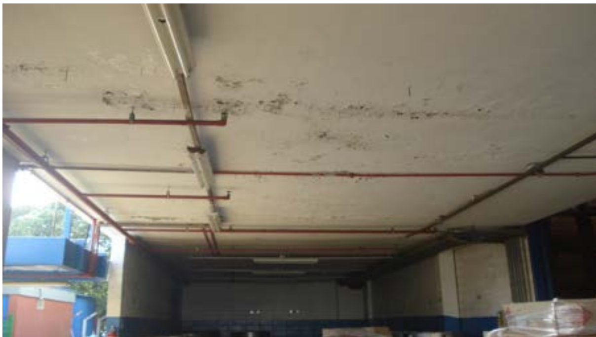
Figura 36 - Evidência de estrutura da área de Expedição necessitando de limpeza e reparos.
