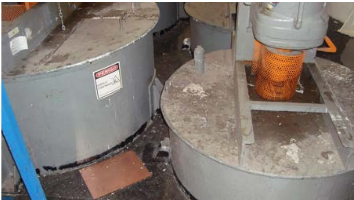
Figura 11 - Evidência de tanques mexedores com excesso de sujeira incrustada.
