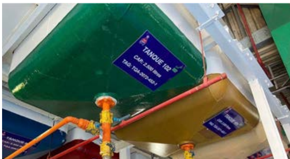
Figura 32 - Identificação de Tanques.
