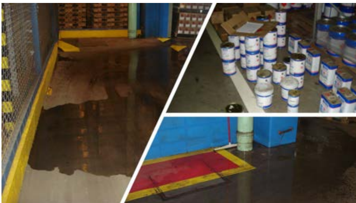
Figura 37 - Evidência de foco de vazamento a ser corrigido, na área de Expedição.
