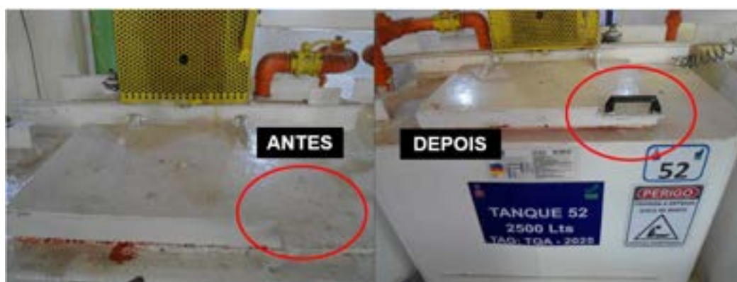
Figura 42 - Adição de alça de segurança em tanques de armazenamento.
