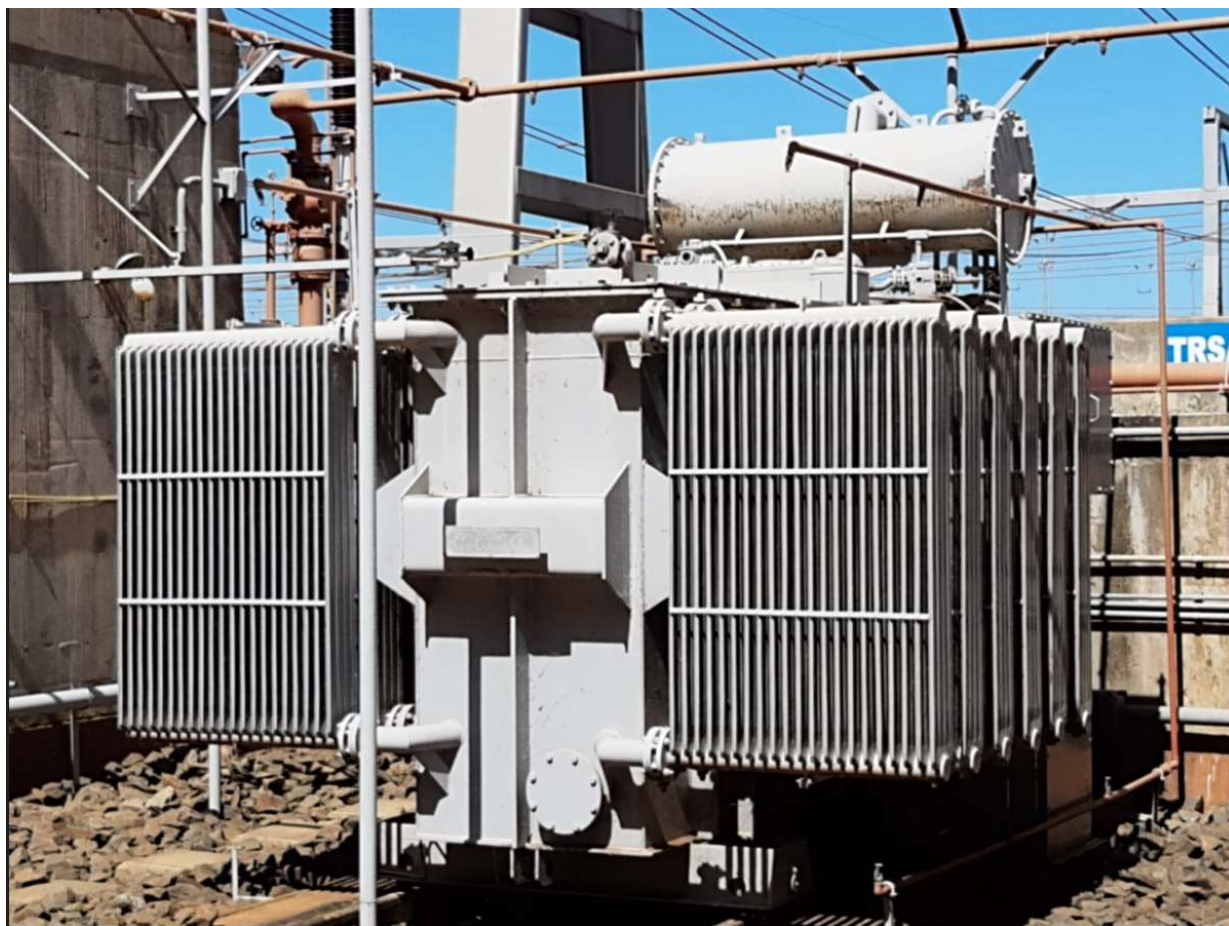
Figura 27 - Transformador Regulador -TRSA.
