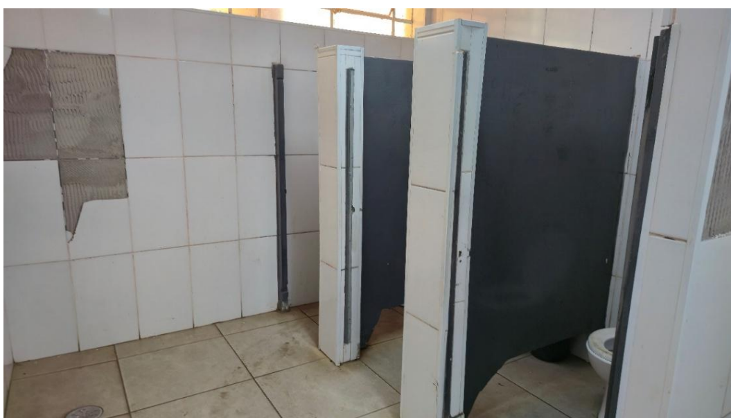
Figura 11 - Imagem do banheiro masculino sem portas
