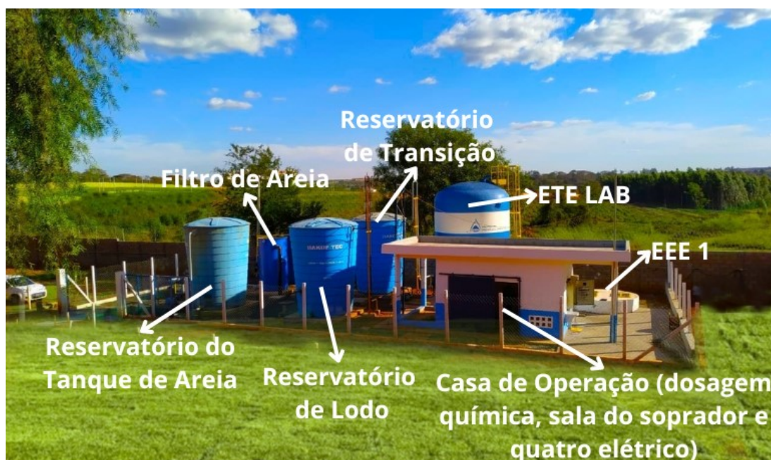
Figura 5 - ETE LAB instalada na CONDUMAX ELETRO METALURGICA CIAFUNDI LTDA em Olímpia/SP
