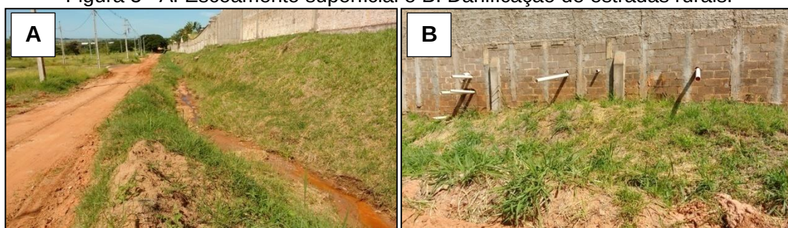
Figura 5– A. Escoamento superficial e B. Danificação de estradas rurais.
