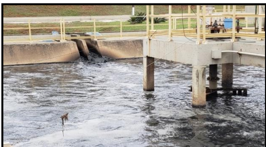
Figura 64 - Entrada do efluente para ser tratado na ETE
