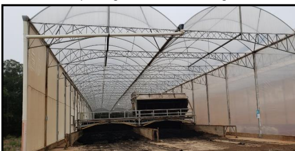
Figura 72 - Visão geral da estufa de compostagem do lodo de esgoto
