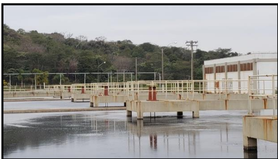
Figura 66 - Tanque de equalização
