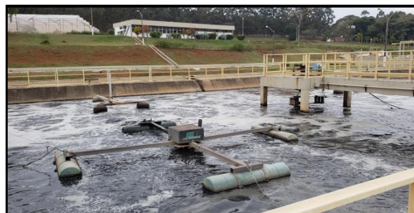
Figura 65 - Tanque de aeração para o tratamento aeróbio
