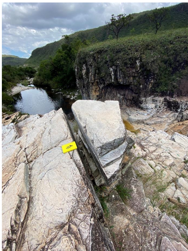
Figura 24: Detalhe da fratura vertical persistente, individualizando a coluna rochosa.
