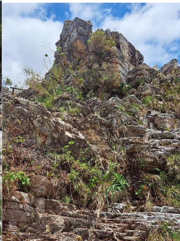
Figura 25: Vista do pé para o topo do talude, evidenciando processos de despredimentos pretéritos e fraturas abertas e persistentes.
