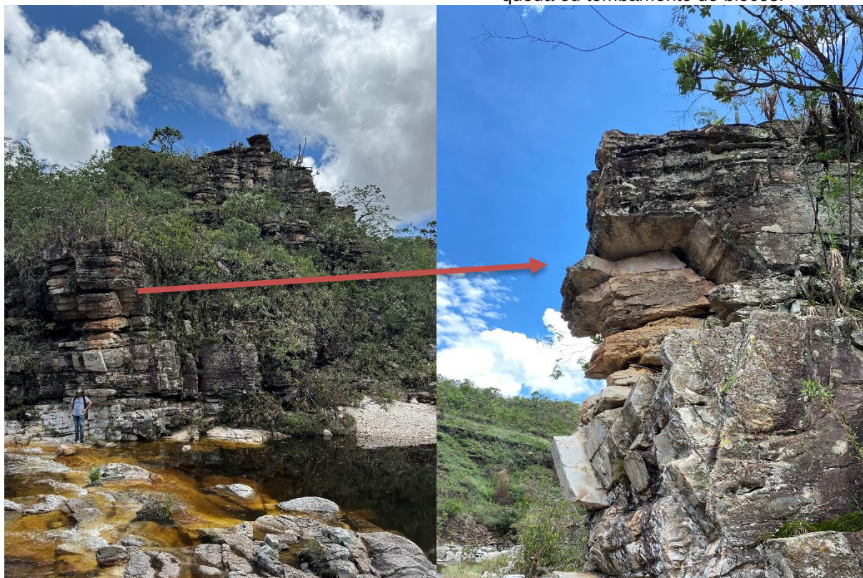
Figura 31: Bloco tabular em balanço ao longo de talude rochoso subvertical em quartzitos da Formação Furnas, individualizado por descontinuidades estruturais e apresentando geometria favorável ao desprendimento por queda ou tombamento de blocos.
