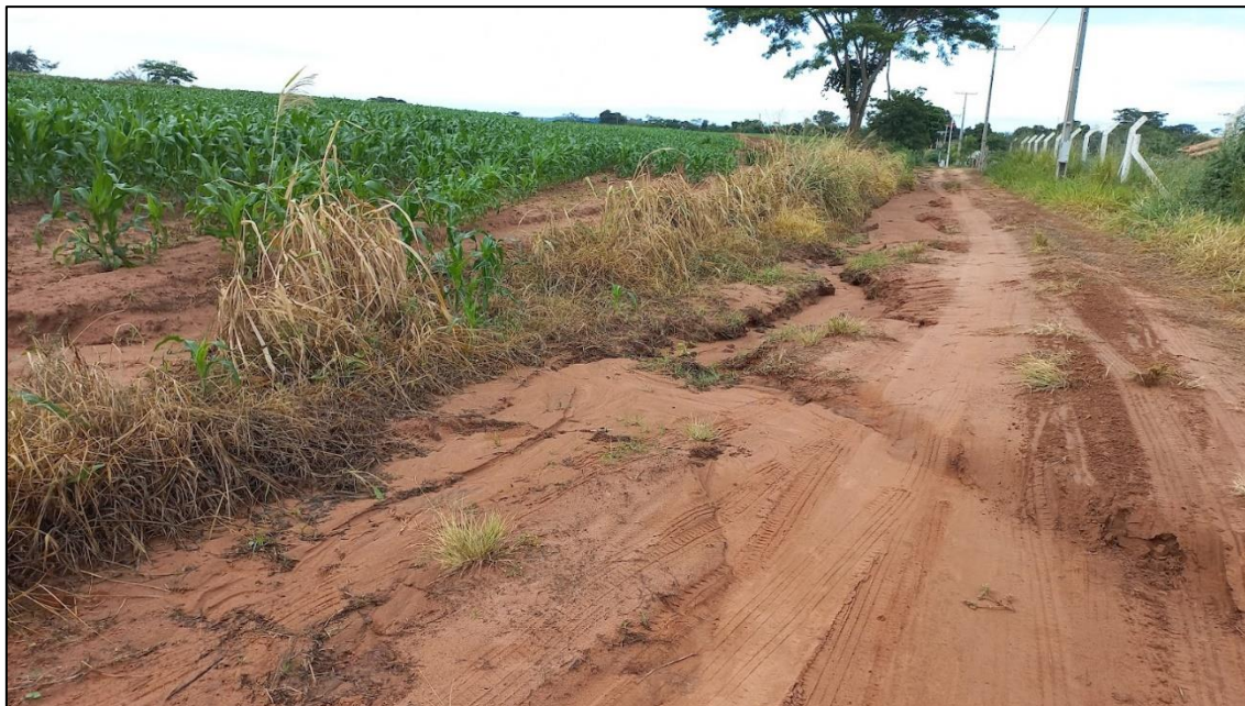
Figura 52: Dano em estrada rural a partir do escoamento superficial de propriedade com cultivo de cultura anual – milho.
