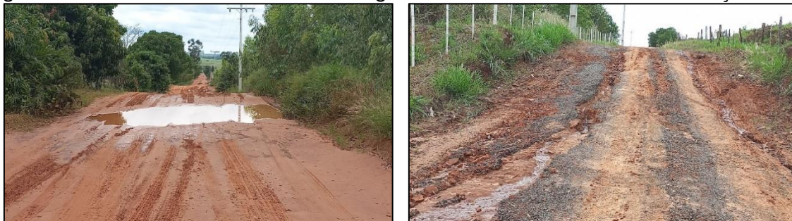
Figuras 50 (A e B). Propriedades rurais elevadas em relação à estrada rural, gerando acúmulo e escoamento de água, danificando as vias de circulação.
