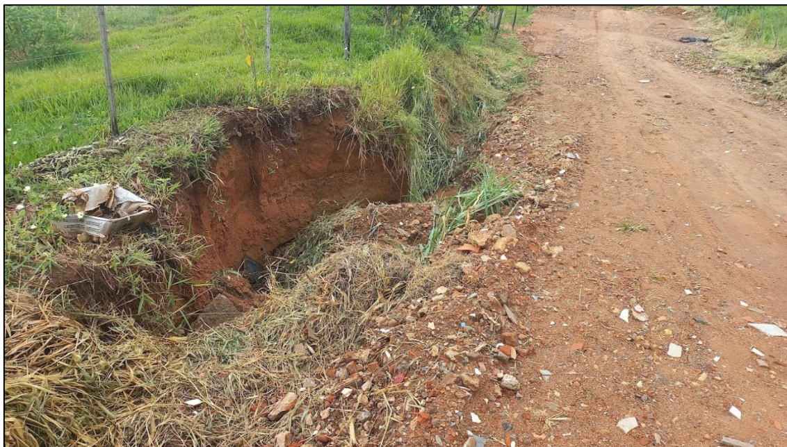
Figura 54. Estrada rural do Bairro Perdido danificada pelo escoamento superficial das águas pluviais.
