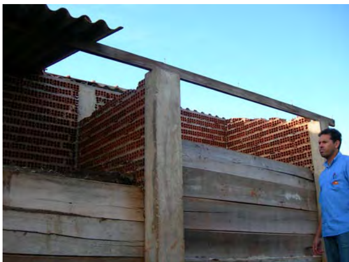
Figura 5: Granja no município de Ubarana – Técnico Renato do Frango NutreBem nos apresentando algumas não conformidades – Telhado descoberto
