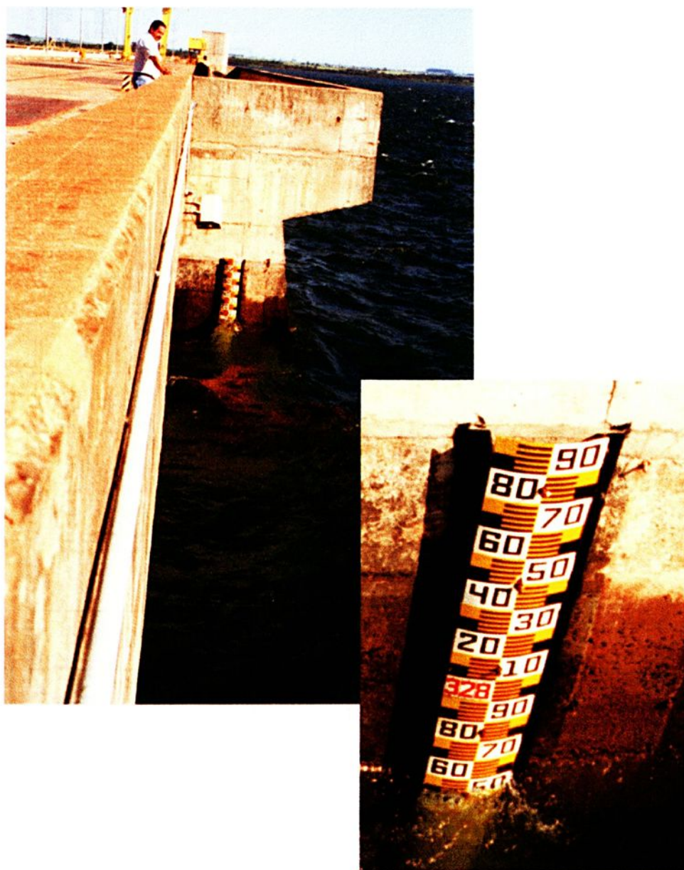
Figura 19 – Vista mostrando limnígrafo instalado à montante da barragem da UHE Três Irmãos e abaixo (em “close”), o mesmo instrumento (Fonte: CESP).
