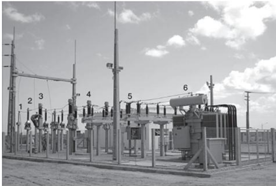
Figura 3 – Visão geral de uma subestação
