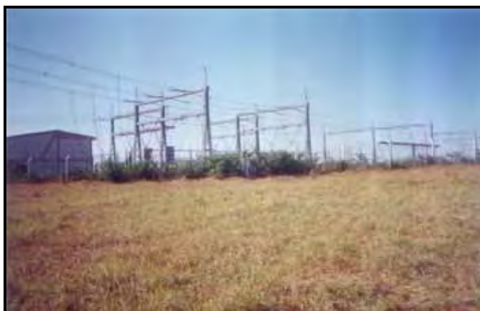
Figura 21 - Companhia de Transmissão de Energia Elétrica Paulista
