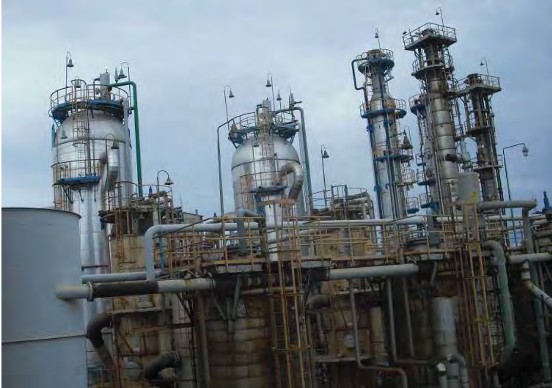
Figura 23: vasos coletores do ar na planta de fenol
