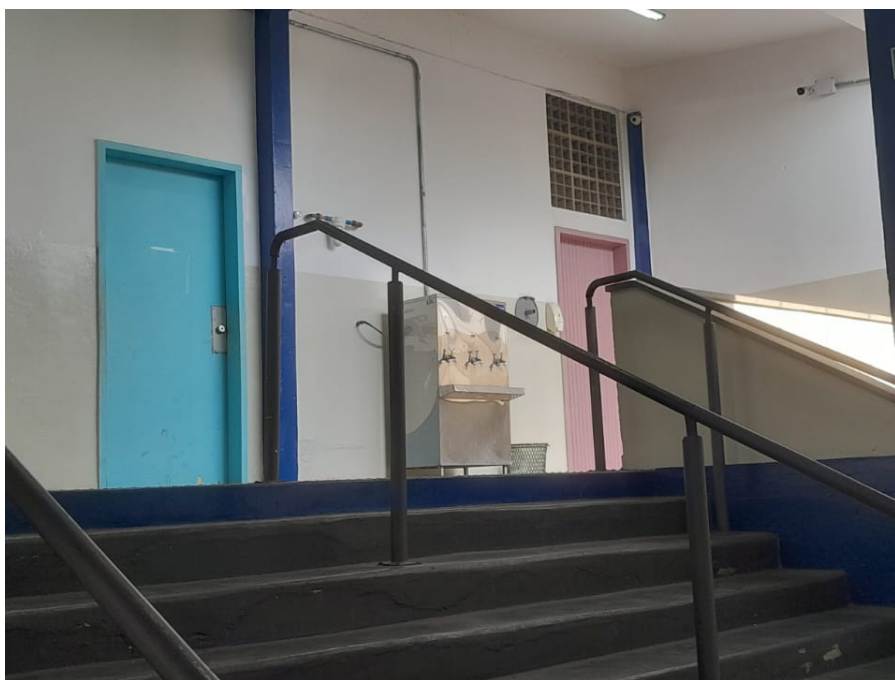
Figura 2- Foto banheiros da escola
