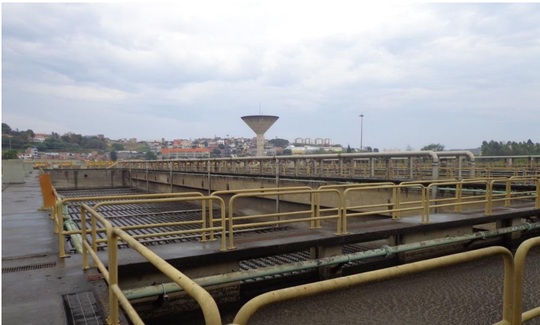
Figura 5 – Visão de armazenamentos de lodo de esgoto gerados na ETE Barueri
