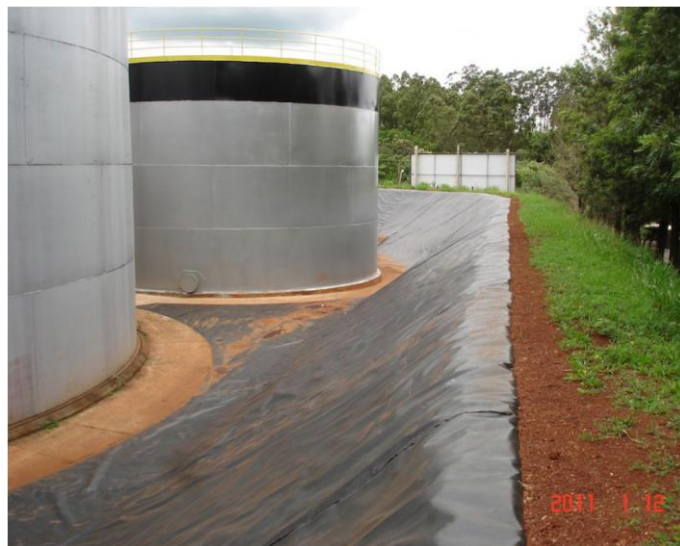
Figura 3 - Bacia de contenção com impermeabilização por PEAD
