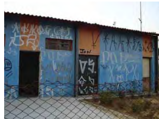
Figura 23 - Vandalismo no prédio dos sanitários
