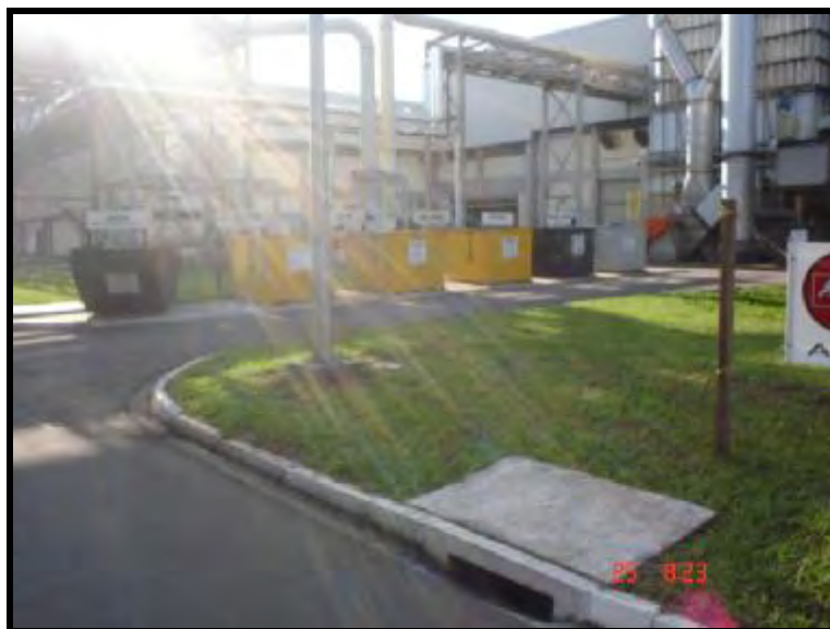
Figura 9 – Acondicionadores da área externa processo seco - capacidade 5m 3 .
