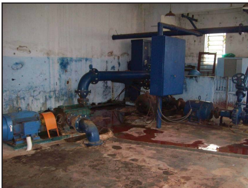
Foto 16: Bombas responsáveis por enviar a água até a ETA
