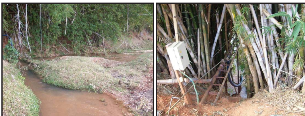
Foto 13: Captação de água no manancial Córrego do Veado
