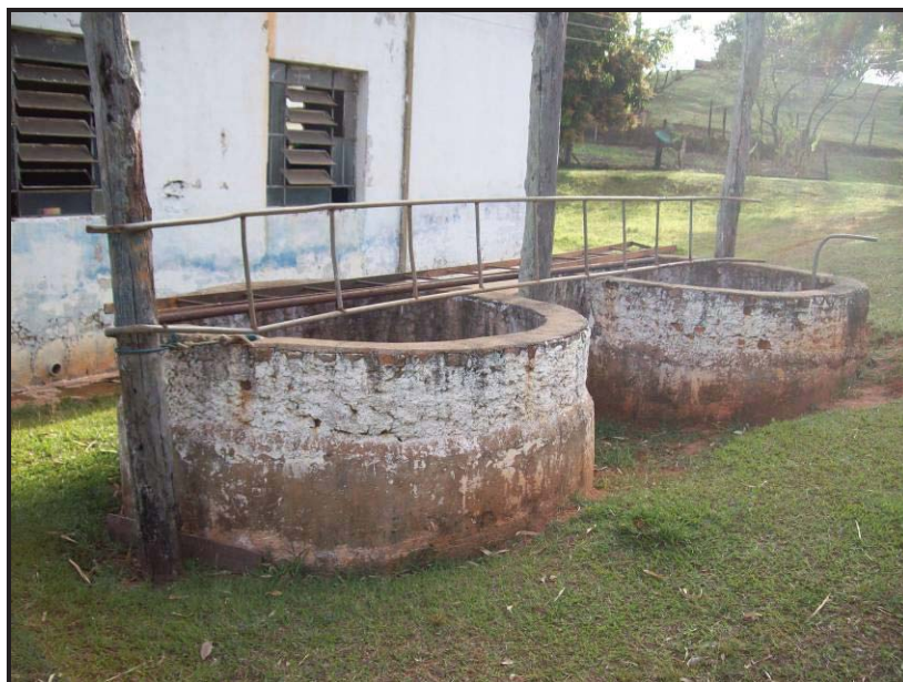
Foto 15: Poços que conduzem a água até as adutoras
