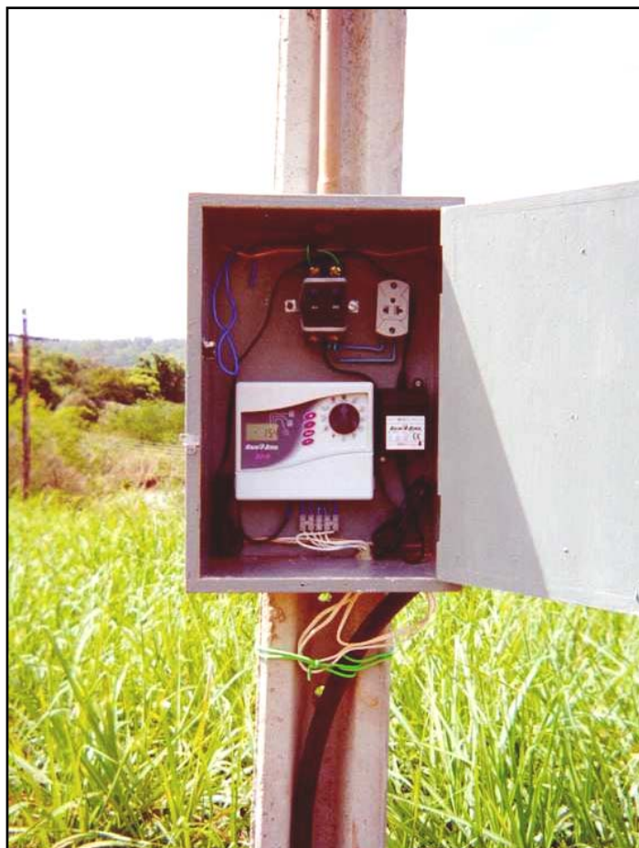
Figura 9. Painel de controle
