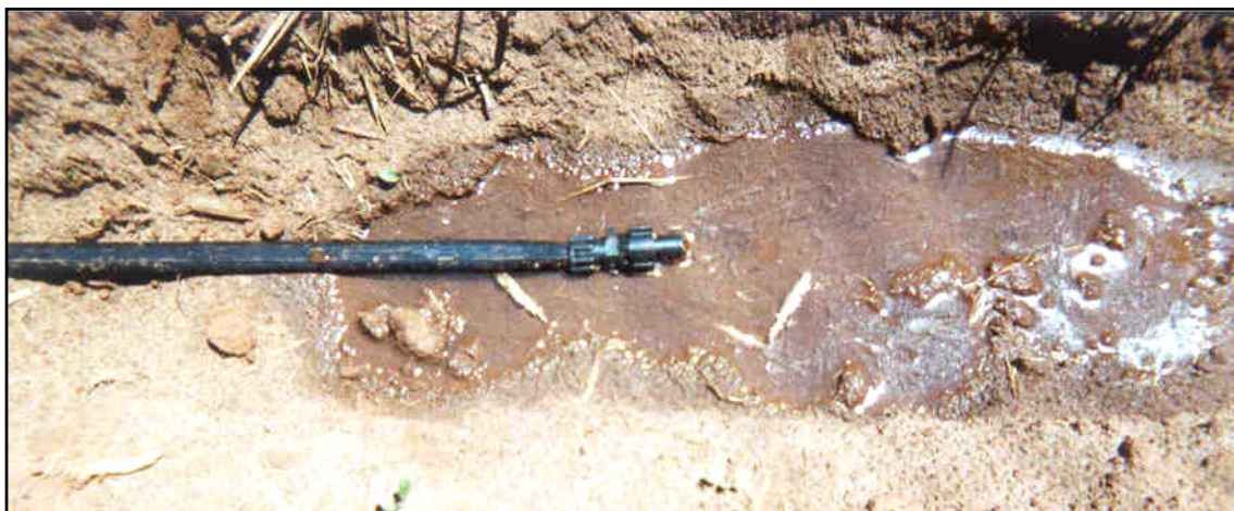
Figura 7. Ação da válvula final de linha. Detalhe para a drenagem da água que estava no interior do tubo gotejador.
