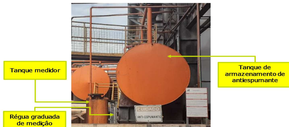
Figura 10. Tanques de antiespumante. Fonte: próprio autor.
