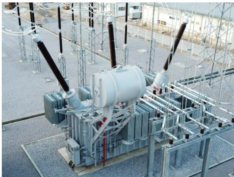
Figura 5 – Transformador de alta tensão
