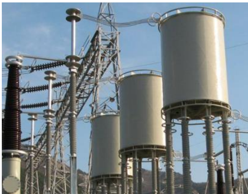
Figura 6 – Reatores de alta tensão em uma subestação
