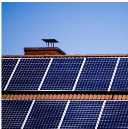
Figura 13 – Sistema de Aquecimento Solar (SAS), disposto de maneira inclinada para maximizar a eficiência do sistema (CADERNO DA CONSTRUÇÃO, 2011).
