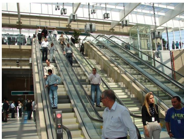
Figura 17 – Escada rolante inteligente, estação de metrô Vila Prudente (VIDRADO, 2011)
