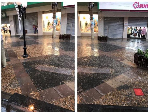
Figura 39 - Piso do Calçadão encharcado e sem escoamento suficiente, em tarde chuvosa durante semana.
