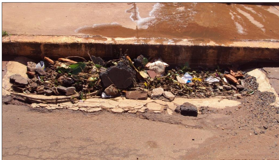
Figura 12 - Obstrução de boca de lobo que impede a drenagem das águas pluviais – Avenida José João Dib
