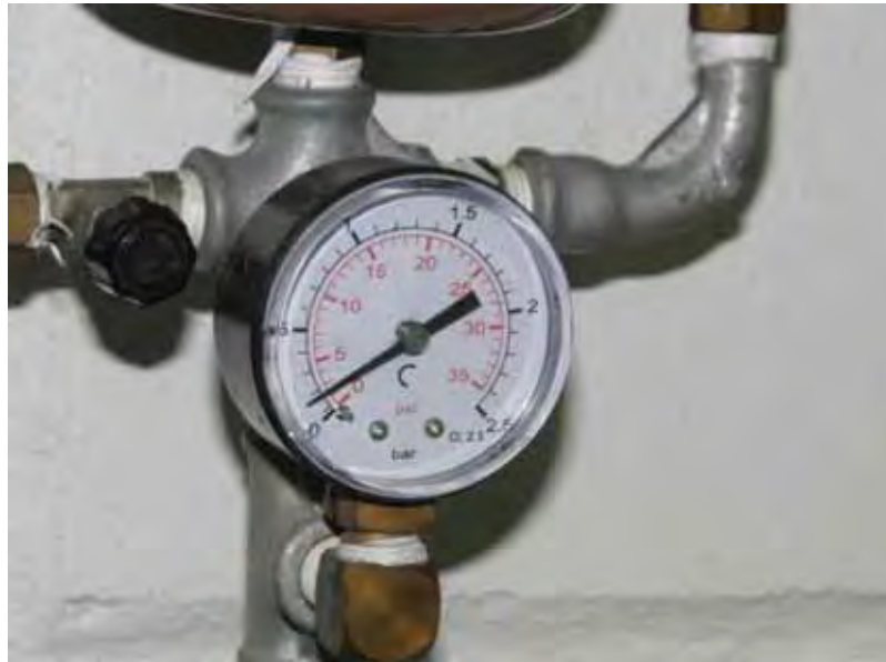
Figura 19 – Manômetro de controle da pressão.
