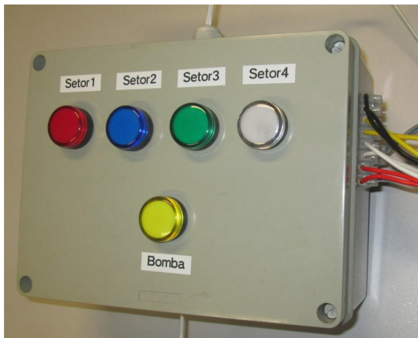
Figura 12a: Nó Atuador – vista externa
