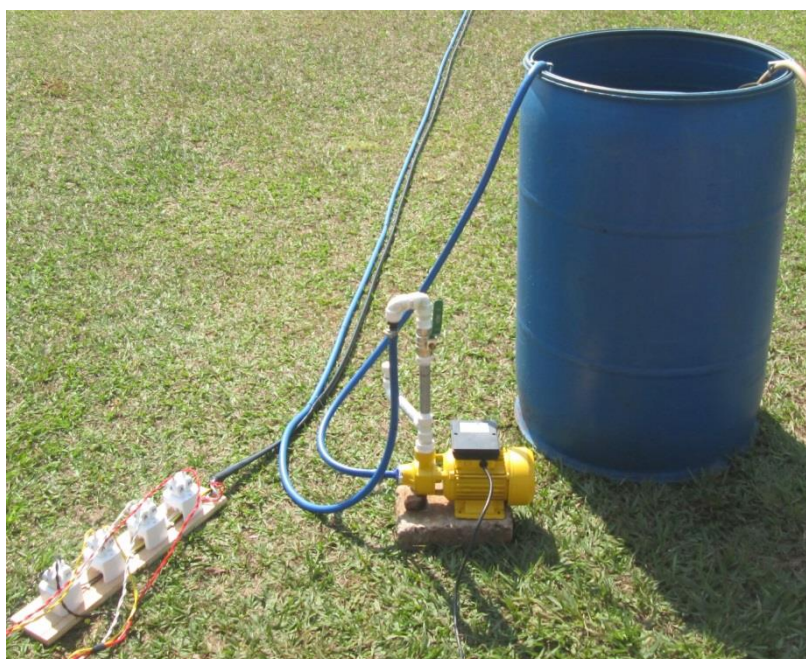
Figura 47b: Reservatório e conjunto moto-bomba
