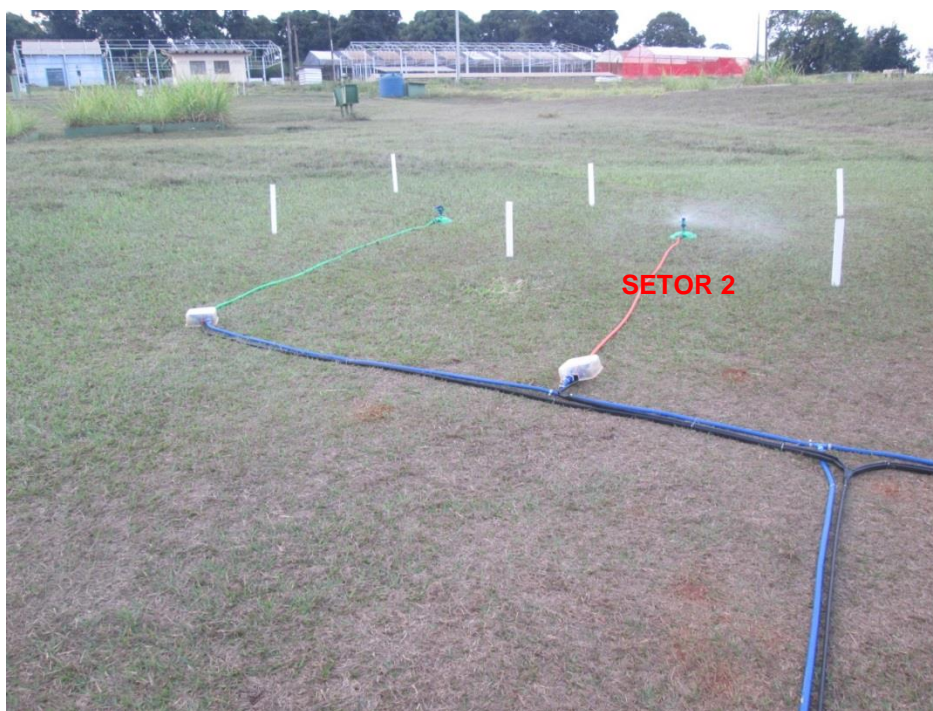
Figura 48b: Avaliação de alcance – Teste 8: Acionamento automático do Setor 2
