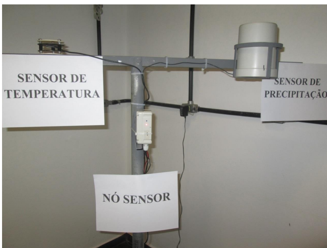
Figura 20: Estrutura metálica de sustentação do Nó Sensor
