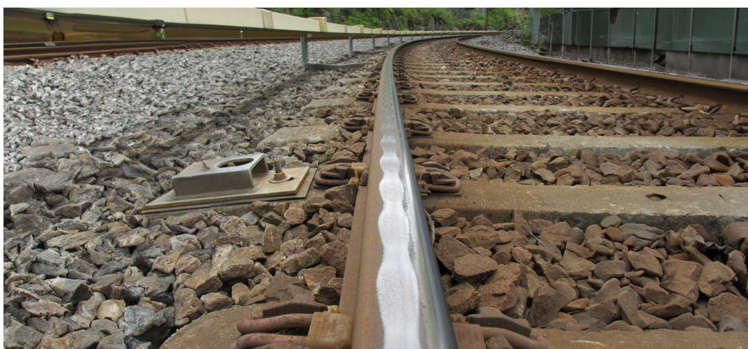
Figura 3: Corrugação em trilho.
