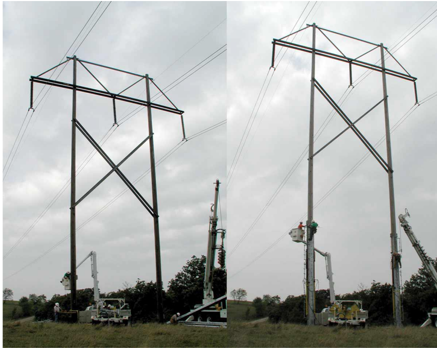
Figura 5 – Elevação de uma torre de transmissão.
