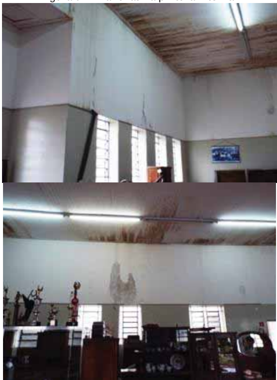
Figura 64 - Manchas na pintura interna.
