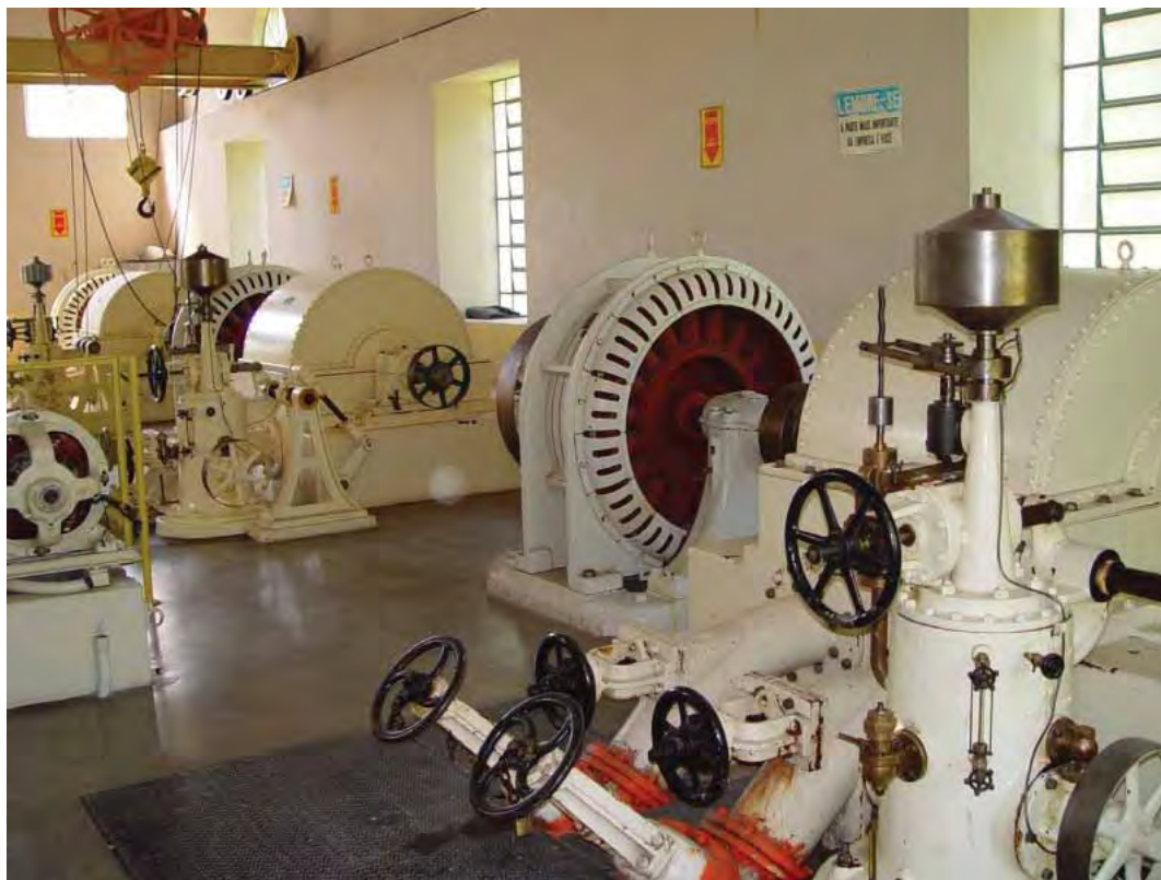
Figura 34 - Casa de Máquinas: PCH Sodr  (DAMATO; PANUNZIO, 2005).
