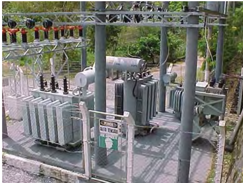
Figura 4 - Subestação Elevadora (Fonte: CERPCH 6 ).
