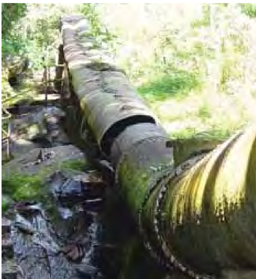
Figura 33 - Tubulação Adutora Danificada: PCH Sodr  (Fonte: DAMATO; PANUNZIO, 2005).
