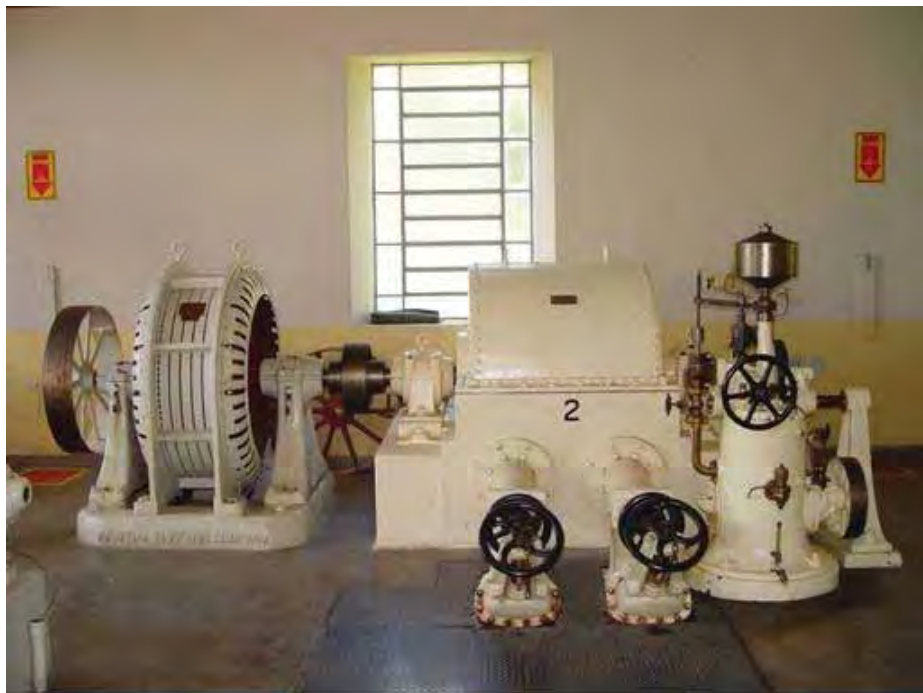
Figura 3 - Grupo Turbina-Gerador (Fonte: GYORI, 2007).
