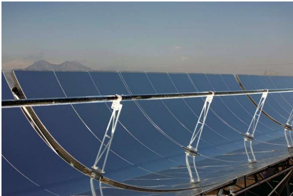
Figura 8 - Exemplo típico de coletores solares de calha parabólica.
