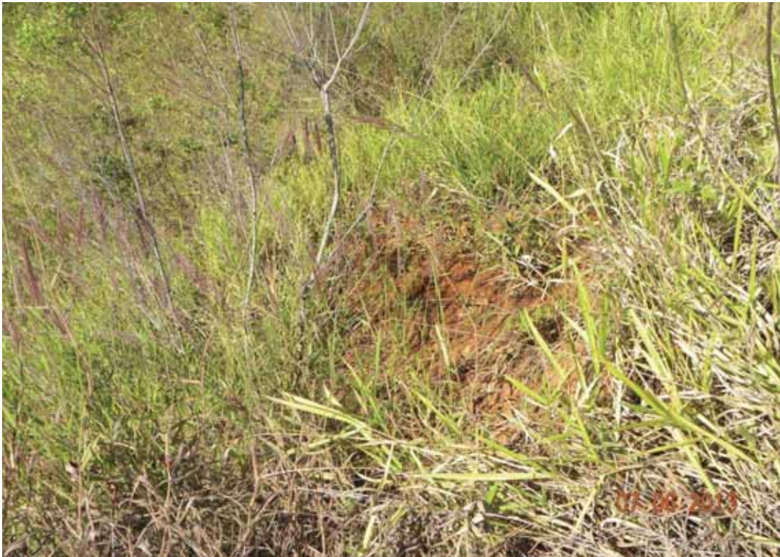
Figura 23. Visualização do talude a jusante da barragem no ponto 3, com alta inclinação e presença de processos erosivos
