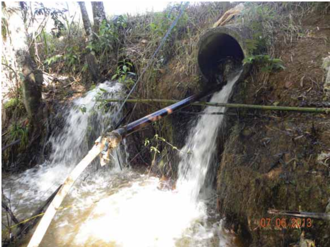
Figura 27. Visualização do vertedouro da barragem no ponto 5, causando processos erosivos.
